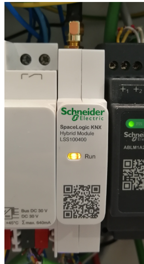
Hybrid-Modul im Schaltschrank
